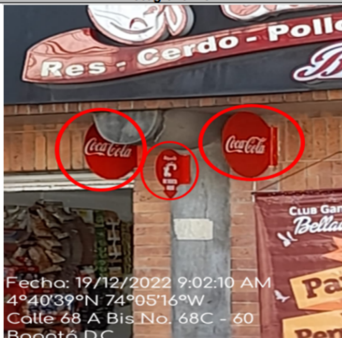
Fotografía en la cual se evidencia TRES (3) elementos salientes de la fachada
